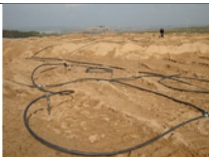
Vystrojení plochy rozvody a sondami
