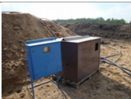
technologické zázemí – dmychadlo
