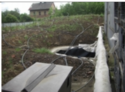
Vystrojení plochy rozvody a sondami
